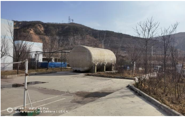
污水处理后回用水暂存水箱
